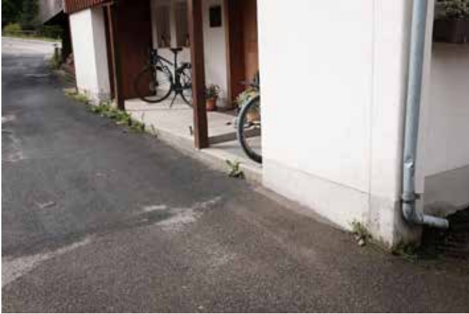
Vorbereich Haus 1623: Zurückgesetzter Zugangsbereich. Strasse bis an Fassade bitumiert.
