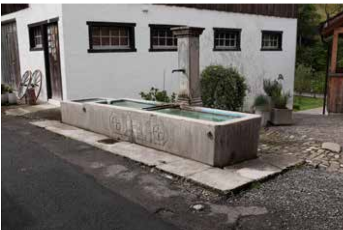
Unterer Dorfbrunnen auf Liegenschaft 1134 der Wasserversorgung Burgau: Brunnen und Umfassung schadhaft.
