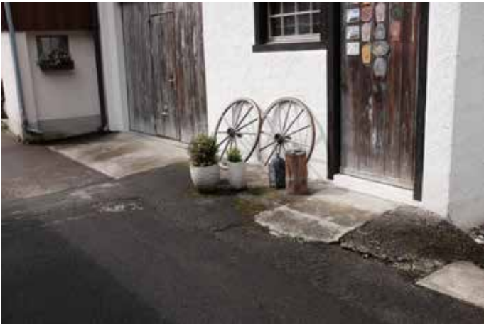
Remise 1624 bei Brunnen. Garageneinfahrt und Zugang. Betonierte Vorbereiche im Wechsel mit Bitumen. Gefälle zur Strasse und zum
