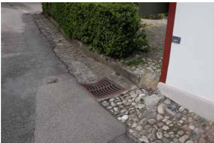
Entwässerungsrinne entlang des Gartens von Liegenschaft 1133 (Haus 1632). Der Garten wird durch einen Stellstreifen aus Betonelementen gehalten.
