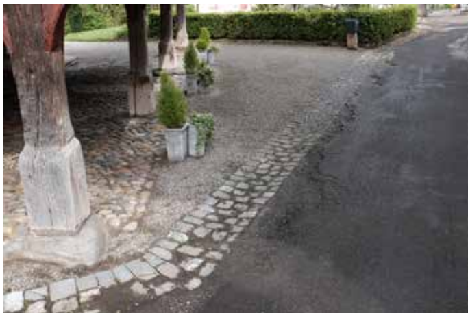
Entwässerungsrinne als Strassengrenze entlang des Rathauses.
